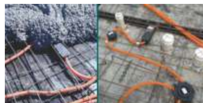
Caixas de laje, união direta do eletroduto, 100% estanque, evitando o entupimento pelo concreto;
