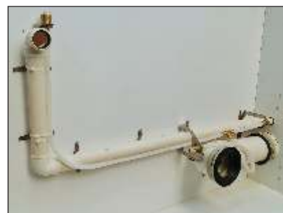
9 - Kit hidráulico completo instalado
