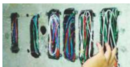
Circuitos (fase, neutro, retorno, paralelo e terra) c/ cores diferenciadas, facilita a identificação
