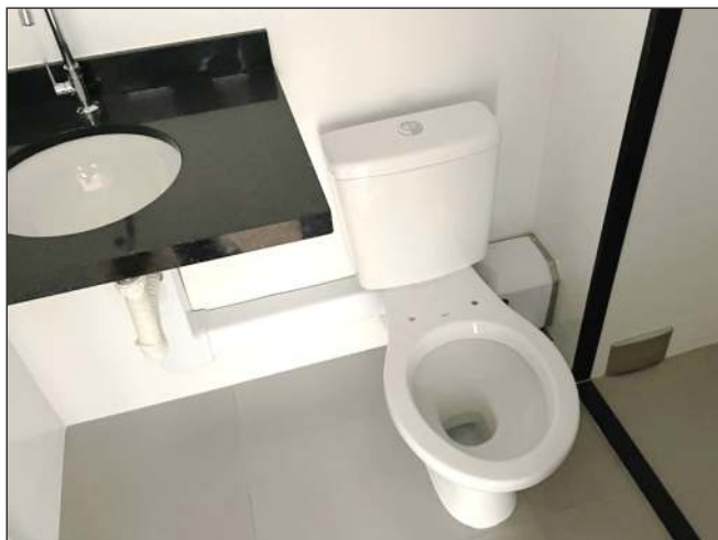
13 - Kit módulo de sobrepor instalado
