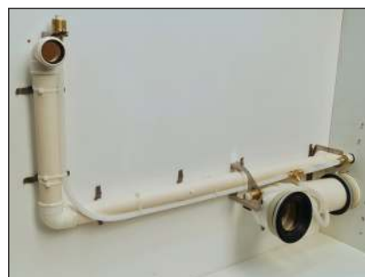
9 - Kit hidráulico completo instalado
